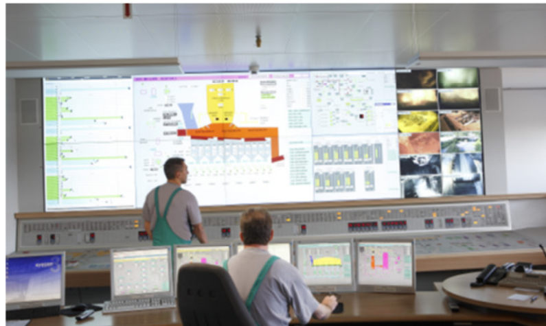
Abbildung 33: Mess- und Steuerwarte MHKW Iserlohn
